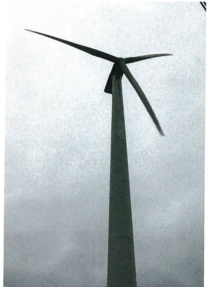
Ikaalisissa Teiharjun laella pyörivä 1000 kW:n Nordex tuottaa vuodessa sähköä noin 1 000 000 kWh. Voimalan masto on 60 m korkea.
