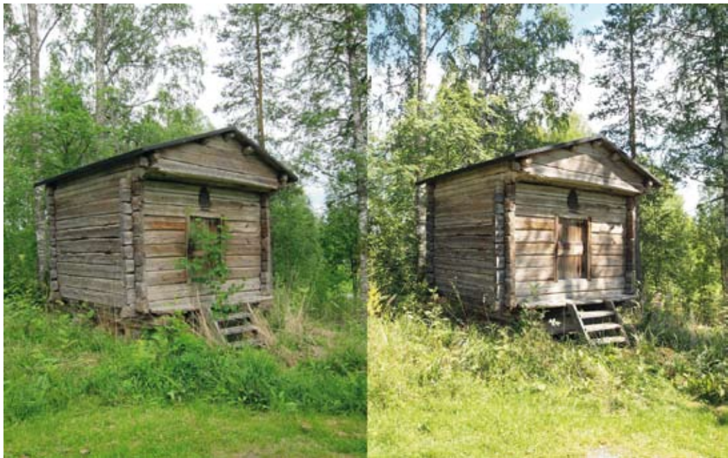
Rakennusten viereen kasvaneet puut ja pensaat kannattaa poistaa, jotteivät rakennukset pääse vaurioitumaan eivätkä jää kasvillisuuden piiloon. Nyrkkisääntönä voi pitää, että kasvillisuus pidetään vähintään puolen metrin etäisyydellä rakennuksista.
