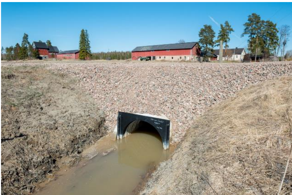
Kuva 14. Rummun yhteyteen rakennettu säätöpatorakenne Hardombäckenillä loviisassa. Patorakenteella pyritään pitämään yläpuoliset sortumat koossa vesipaineen avulla. Kuvassa patolankut on otettu pois talven ajaksi. Kokeilu on vielä kesken. Etelä-Suomen Salaojakeskus.
